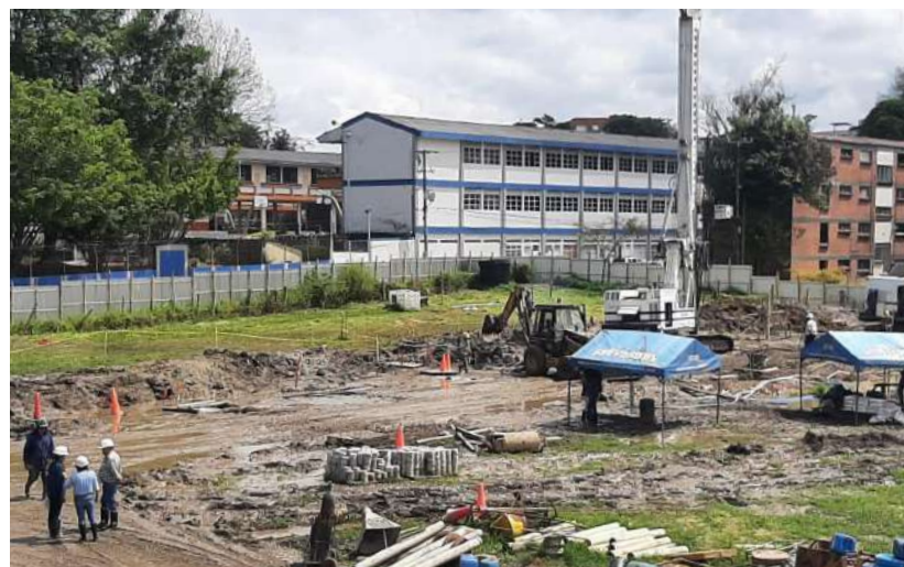
En este sitio se construye la nueva sede Administrativa de Comfacauca, en el barrio Modelo de Popayán.
